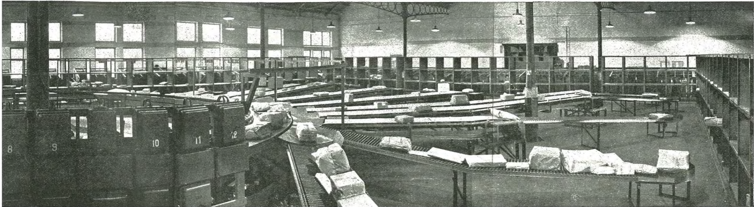
Fig. 8. — 2°) Vue panoramique de l'installation. t de la gauche vers la droite. Au premier plan, le tableau blindé automatique de l'installation. La mise en marche et l'arrêt des 12 moteurs sont mandés à distance au moyen des boutons poussoirs visibles sur la figure 7 à gauche, à l'intérieur de l'anneau de triage.
