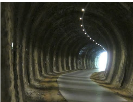
Intérieur du tunnel de Burziheid qui livre aujourd'hui le passage au Ravel
