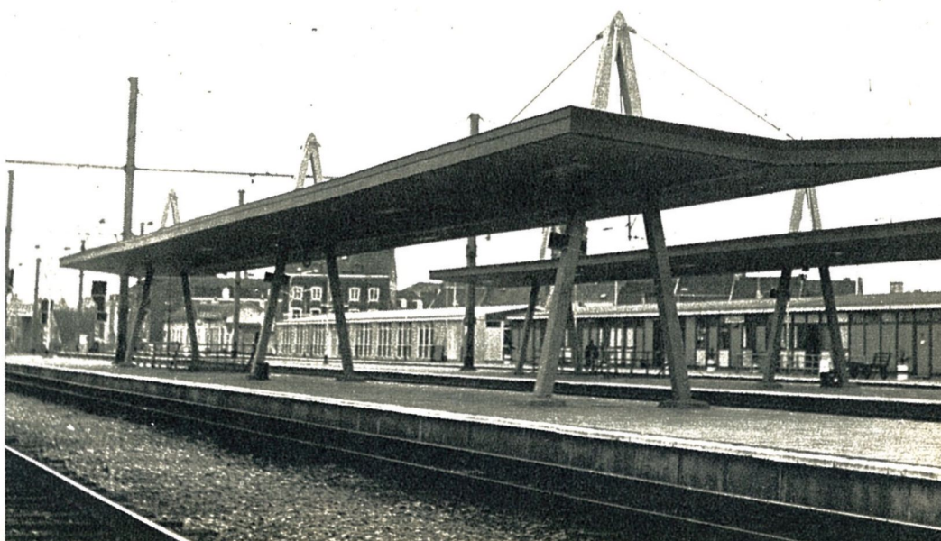
Photo 12 : Abri-parapluie à portiques en Y renversé en tôles épais- ses formant caisson. Les tirants ont la même fonction que dans l'abri de la photo 11.
