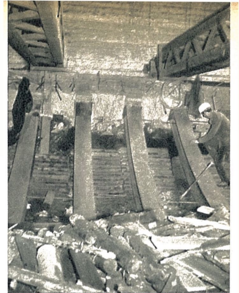
Photo 9 : pose des cintres de radier sur les tôles de répartition. On remarque les deux poussards de 100 t contre-butant les piédroits.
