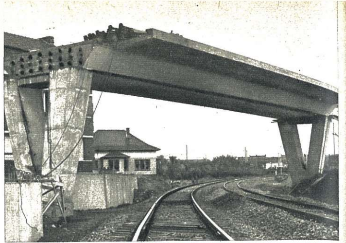
Een brugdek van 26,50 m overspanning op zijn ondersteuning na verwijdering van de bekisting. Let op de verankeringskoppen van de kabels.
