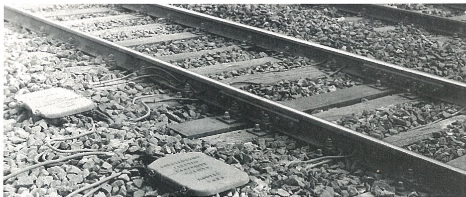
circuits de voie ▲
