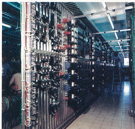
un des nombreux châssis de la salle des relais
