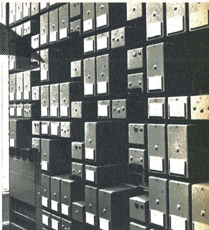
Raamwerk van de afstandssignalisatie die de elektronische uitrusting bevat.
