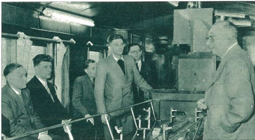
Desserte d'une cabine électrique (type normal).
