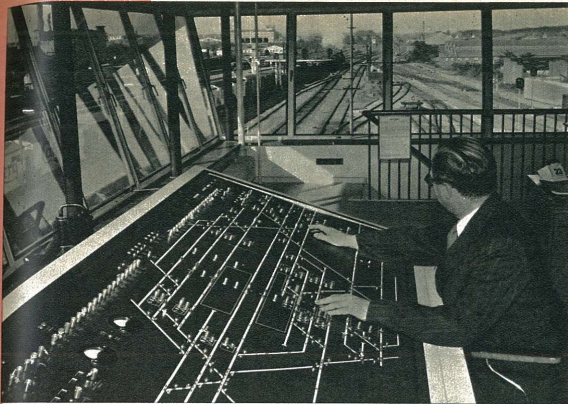
Poste de commande tout relais d'Odense.
