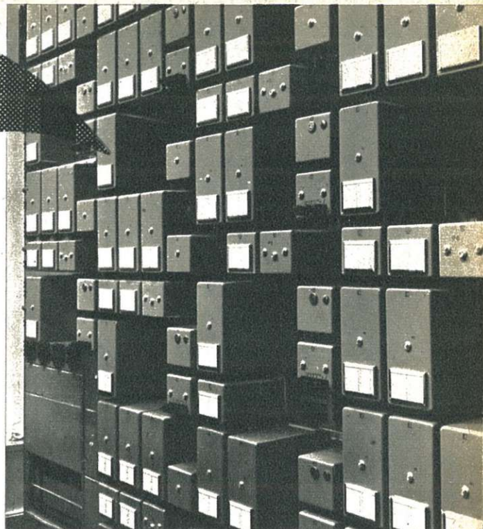
Bûts de télésignalisation contenant l'appareillage électronique.
