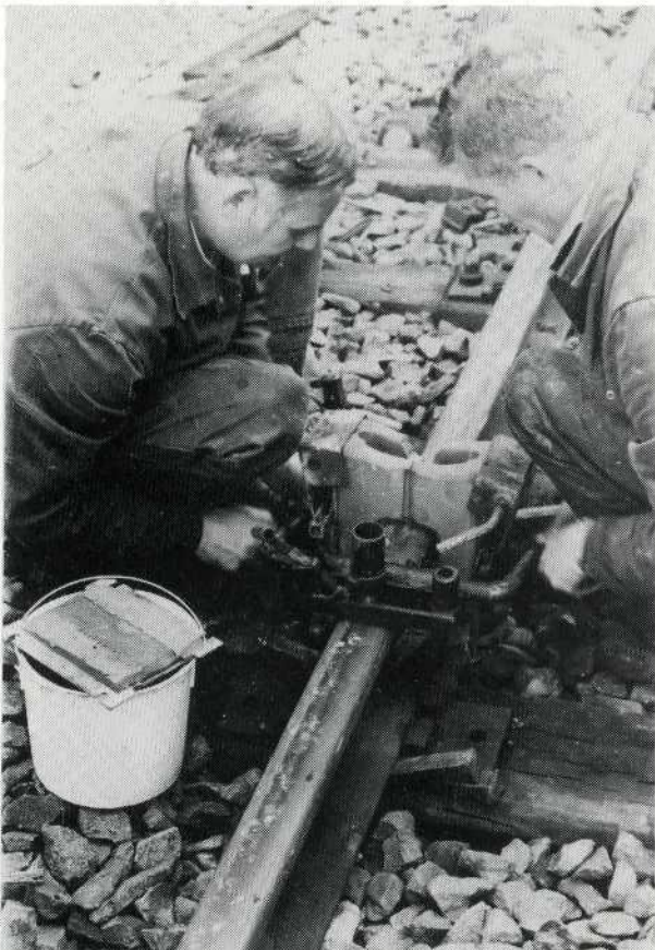
Figuur 8.20 Bevestiging van de gietvorm in de gietvormhouder.
