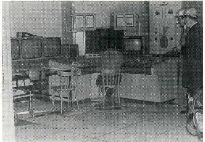
Figure 4.26 Poste de commande du convertisseur LD-AC.
