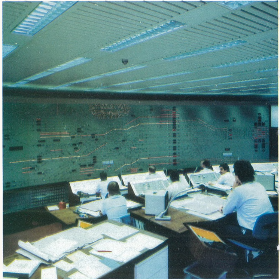
De schakelkamer met het optisch controlebord (OKB)
