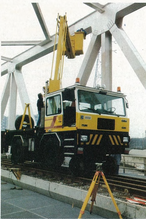
DE BRUG TIJDENS DE BOUW; LET OP DE INDRUKWEKKENDE AFMETINGEN, DE WELVING EN DE BOOGSTRAAL VAN HET SPOOR OP DE BRUG.
