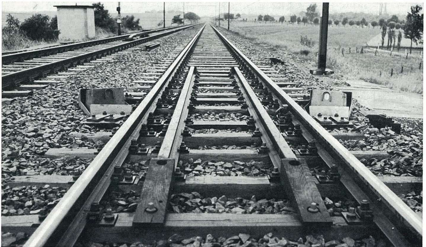
Deux lecteurs électroniques disposés de part et d'autre de la voie.
