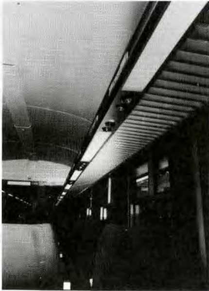
Algemeen zicht van de plafondverlichting.
