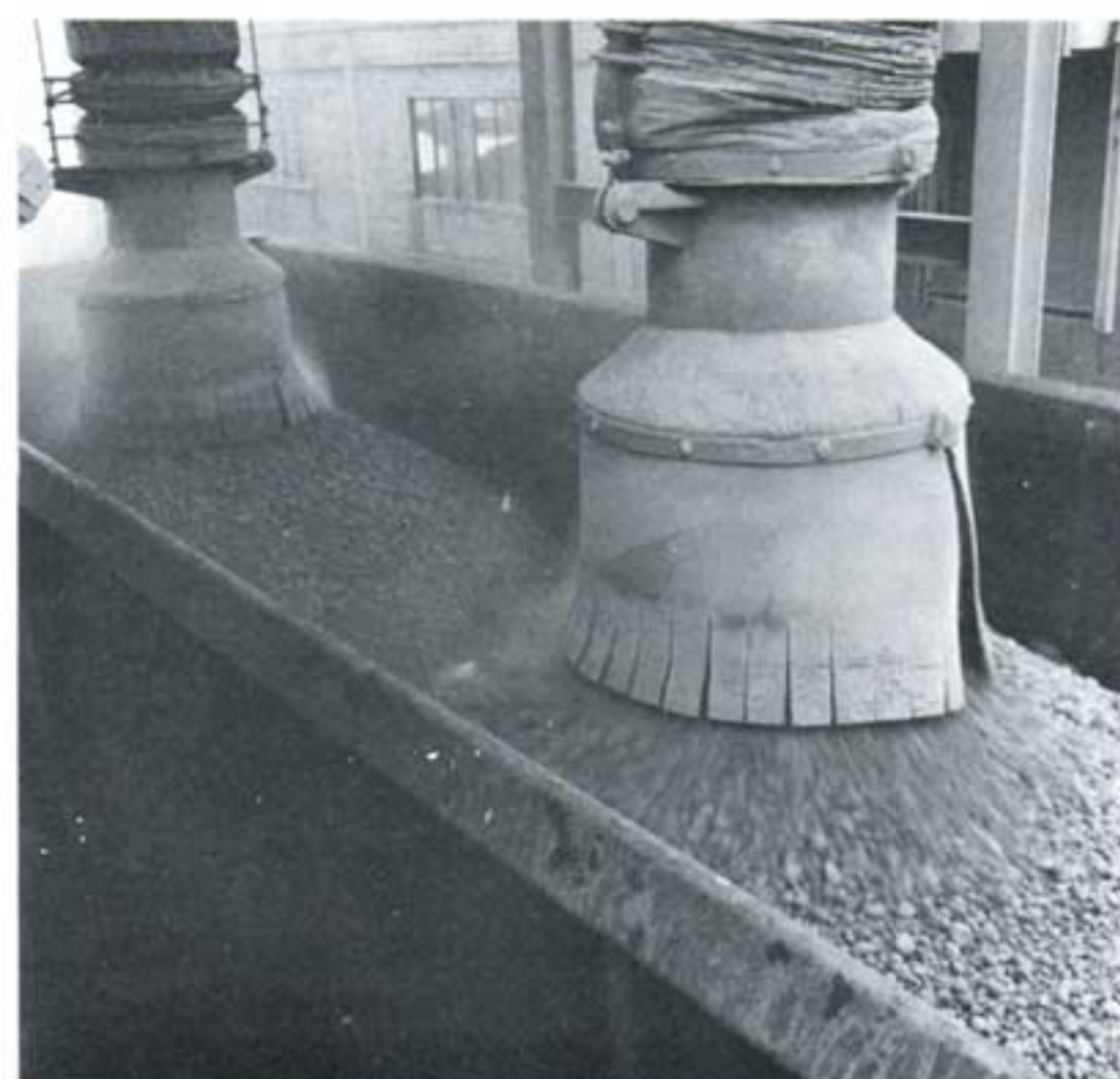
Opération simple : chargement direct du wagon
