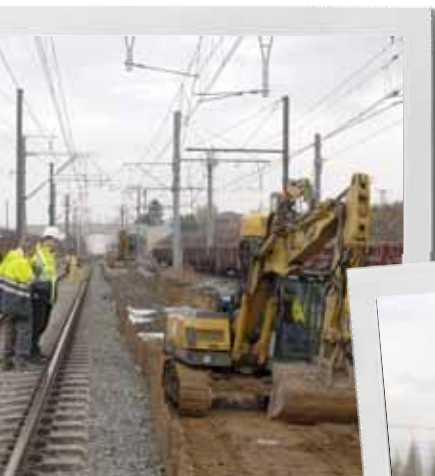
Les premières étapes sont le déblaiement de la plateforme, sous le ballast, et l'évacuation des terres.
