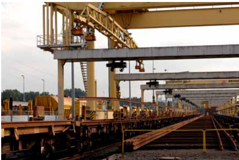
Une fois les rails assemblés, ils sont placés sur le train à l'aide de grues spéciales.
