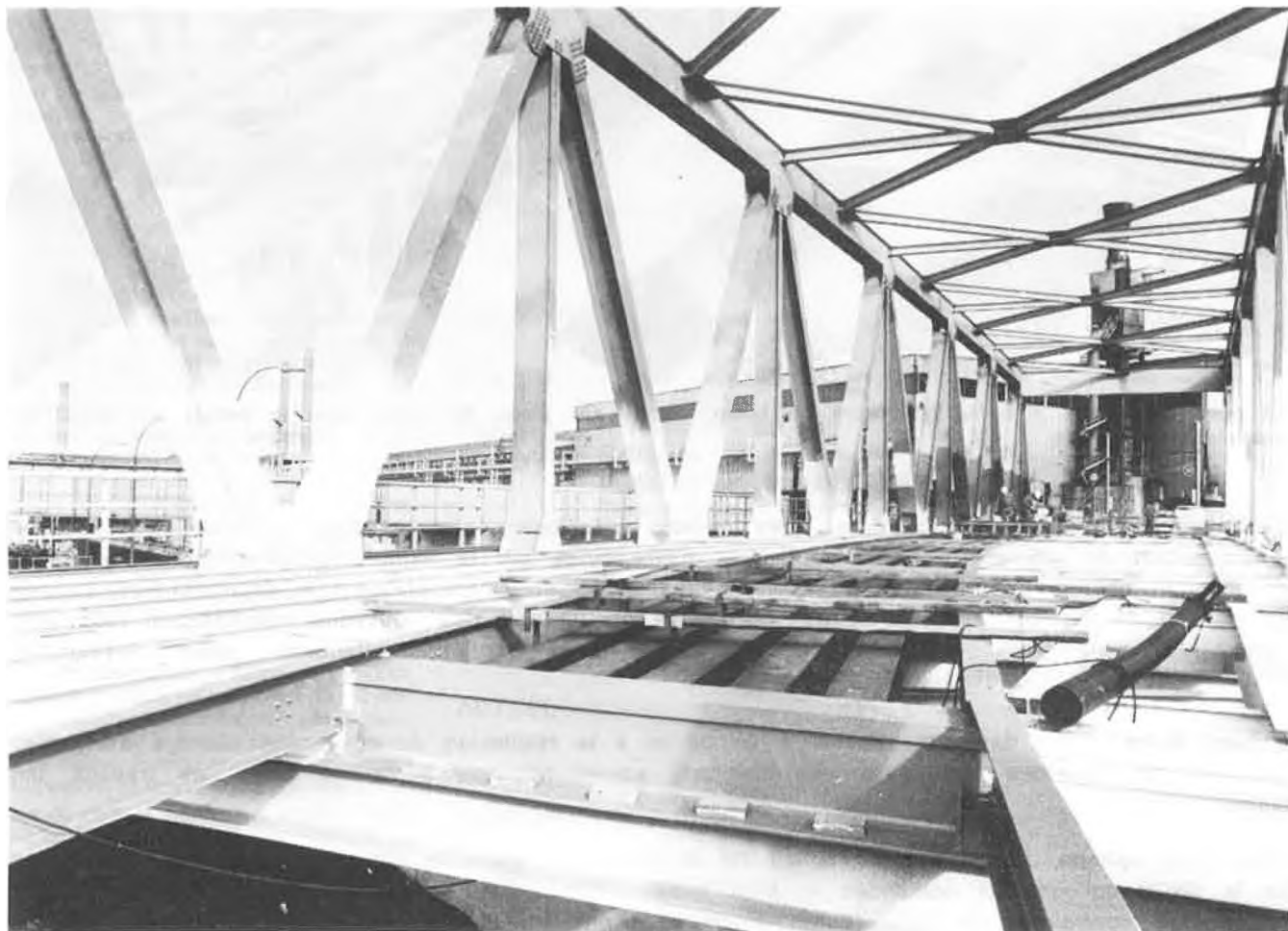
Le nouveau pont accueille une voie dont le rayon de courbure en plan est de 190 m. Détail des entretoises appelées à supporter les bacs à ballast tout en reportant l'effort sur les poutres maîtresses. Remarquez la largeur exceptionnelle du pont en raison du rayon de courbure de la voie unique.
