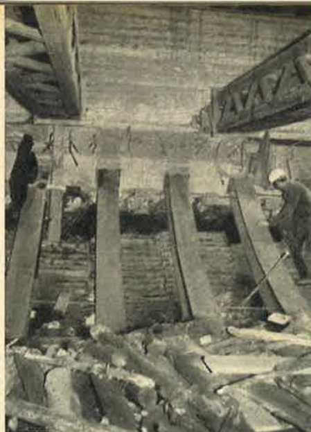
Foto 9 : plaatsen van de vloerformelen op de verdelingsplaten. Men bemerkt de 2 stutten van 100 t die de steunmassieven schragen.
