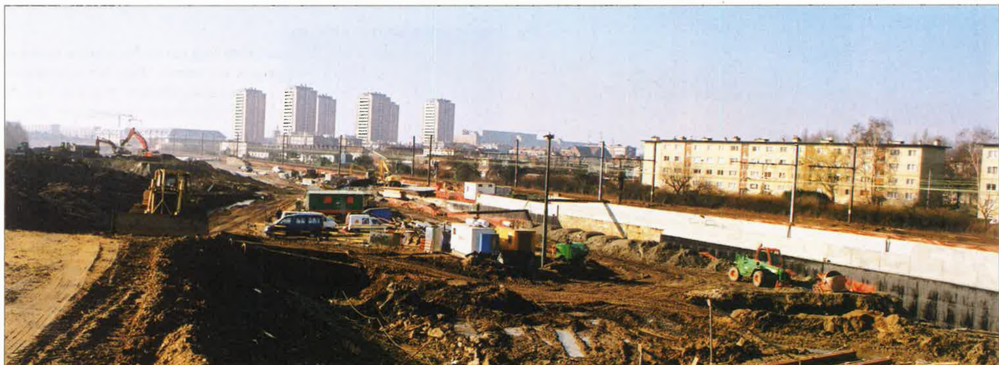
Vanop de brug van de Havanastraat hebben voorbijgangers en geïnteresseerden een mooi overzicht van de gigantische bouwwerf in de zone Luchtbal en omgeving.
