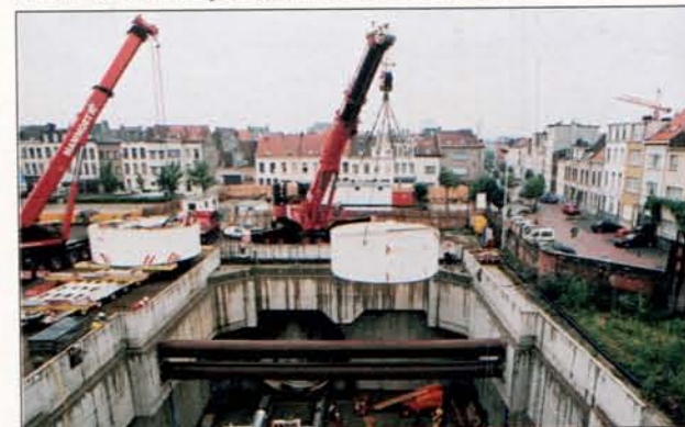
Voor het neerlaten van het ronde boorschild in de bouwput waren twee stevige kranen nodig.
