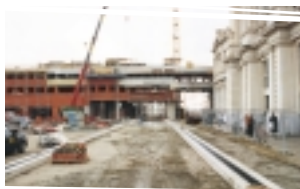
De NMBS deed de voorbije jaren een miljardeninvestering in de Leuvense regio. De heraanleg van de stationsomgeving is één van de grootste stedenbouwkundige projecten in Vlaanderen.
