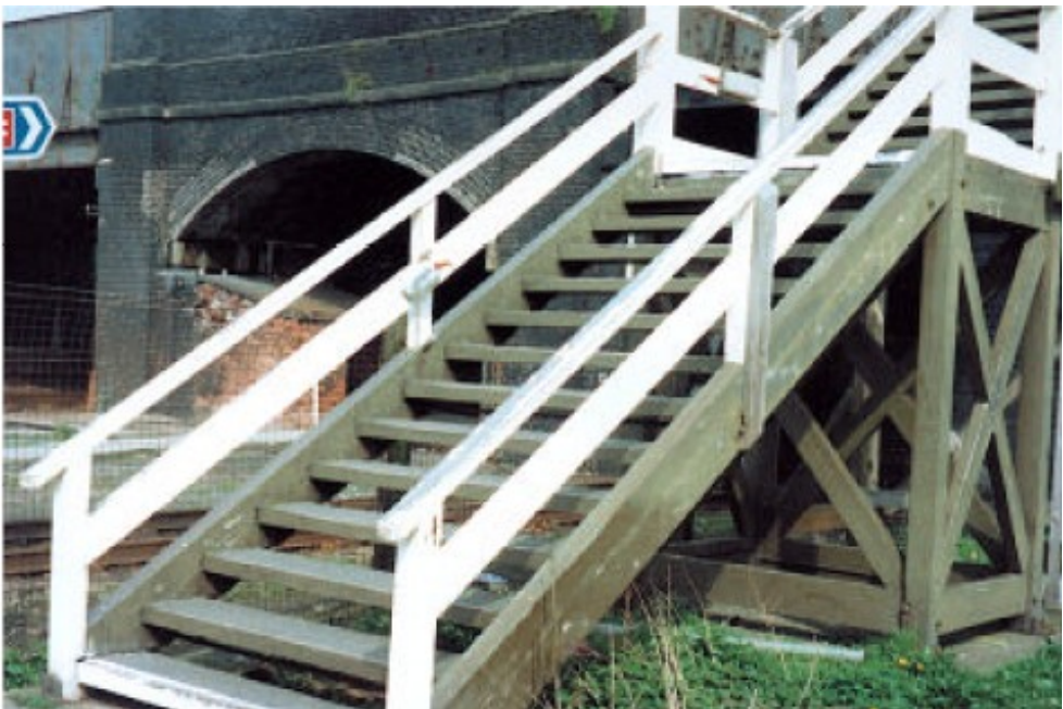
Photo 7. Il convient d'éviter les cages d'escaliers ouvertes qui constituent souvent un danger pour les personnes handicapées
