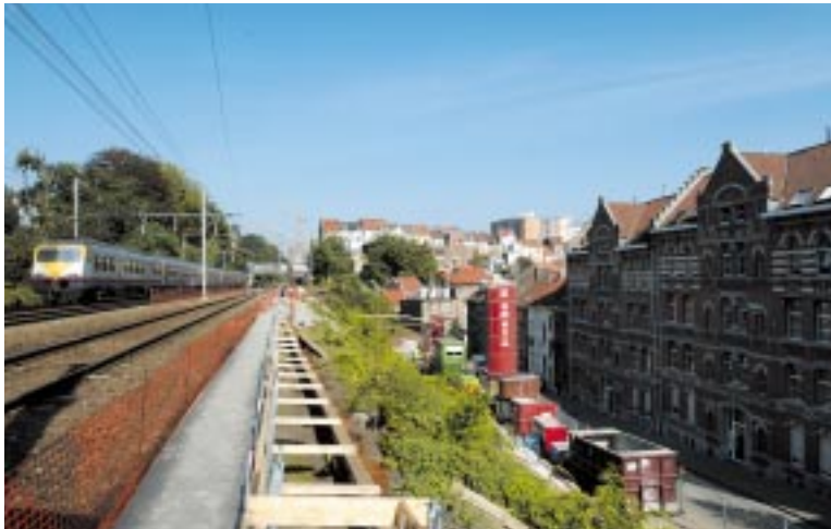
Travaux d'élargissement de la plate-forme ferroviaire le long de la rue des Deux Ponts.
