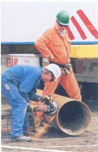
De NMBS doet er alles aan om de werfhinder tot een absoluut minimum te beperken.
