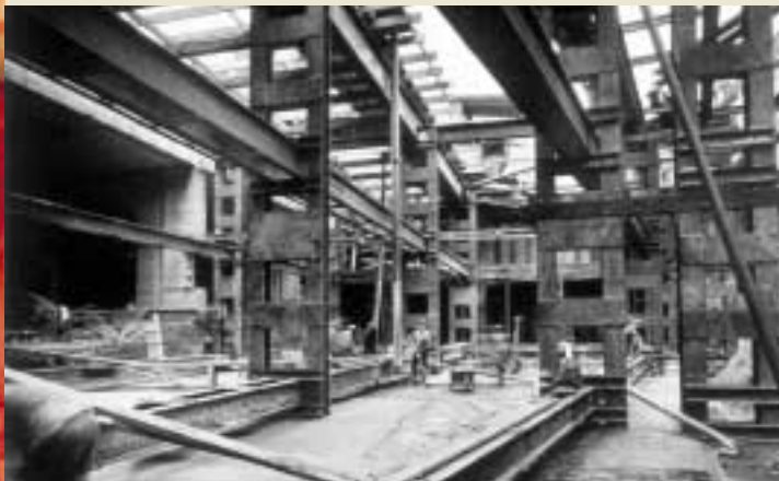
Pour construire l'impressionnante structure métallique du tunnel de la Jonction, on utilisait d'immenses poutres en acier. Photo: Sergysels, collection P. Pastiels
