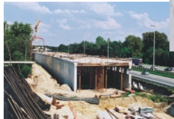
Op plaatsen waar bomen op de spoorlijn kunnen terechtkomen, rijden de treinen in een koker met dakconstructie.
