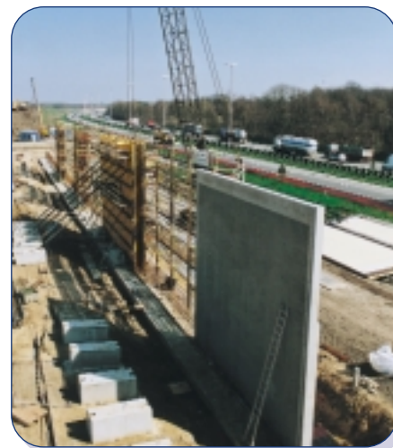
Vanaf de Elshoutbaan gaat de koker van het Peerdsbos over in een betonnen geluidswand. In de geluidswanden bevinden zich gleufjes die ervoor moeten zorgen dat het geluid van de auto's op de E19 niet wordt weerkaatst.
