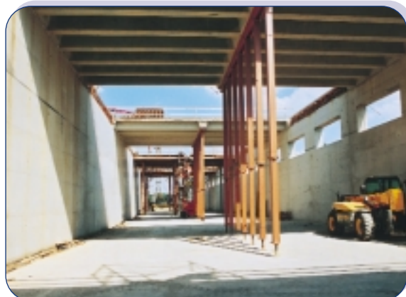
Peerdsbos - In de zijwanden van de koker worden openingen voorzien zodat de luchtdruk - die in de koker ontstaat wanneer er treinen doorrijden - vermindert.
