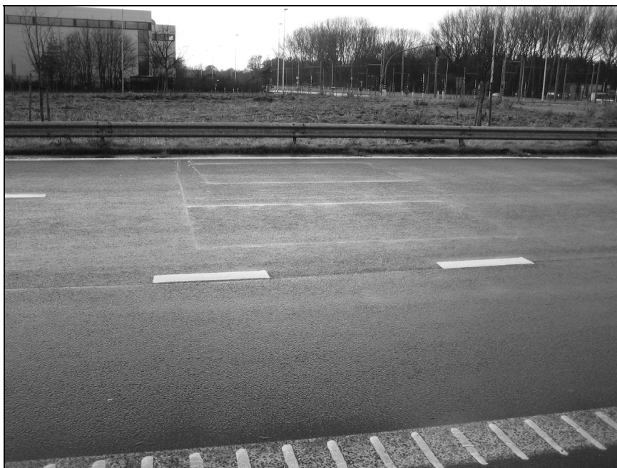
Figuur 1: Twee enkelvoudige lusdetectoren naast elkaar ingebed in het asfalt.
