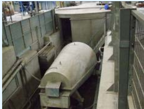
Waterzuiveringsinstallatie voor reinigingswater in Roeselare
