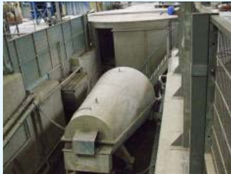
Installation d'un système d'épuration de l'eau de nettoyage à Roulers
