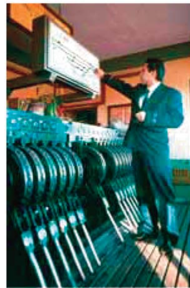
Enclavamientos mecánicos de concentración de palancas
