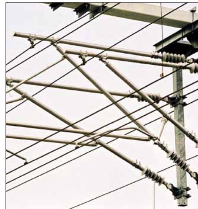
▼ De bovenleiding van een hogesnelheidslijn bestaat uit slechts één enkele contactdraad
