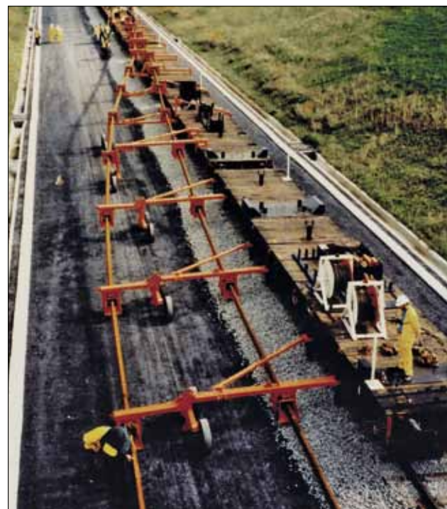
▼ ► Een karwei van veel geduld: de aanleg van een nieuwe spoorlijn gebeurt in meerdere fasen
