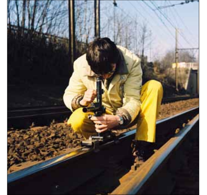
► De aanleg van een spoorlijn is het werk van de meest nauwkeurigen onder ons: alles wordt tot op de millimeter getest
