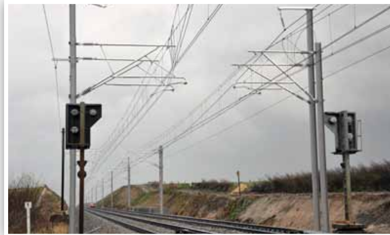
Les caténaires sur la Ligne 162 à hauteur de Barnich
