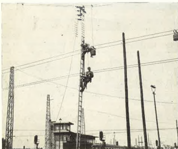
Fig. 25. — Bruxelles-Midi : équipement d'un grand portique souple.
