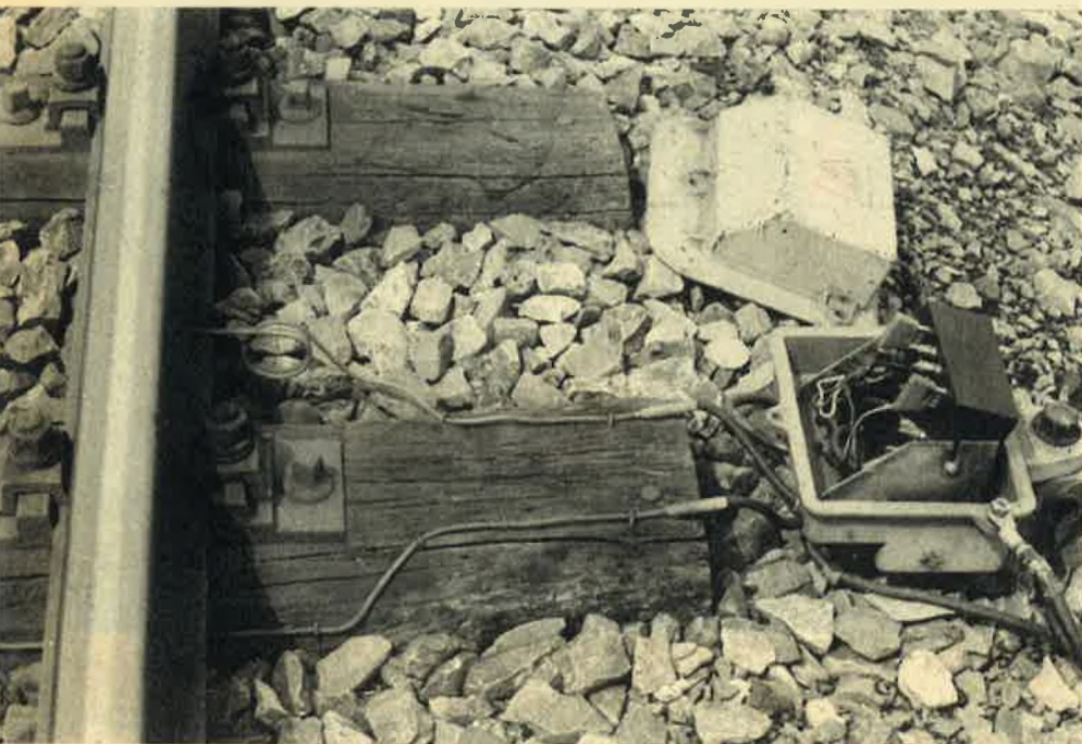
Équipement de circuit de voie court sans joints.
