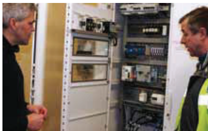
Technici controleren de sturing van de warmtekrachtkoppeling.
